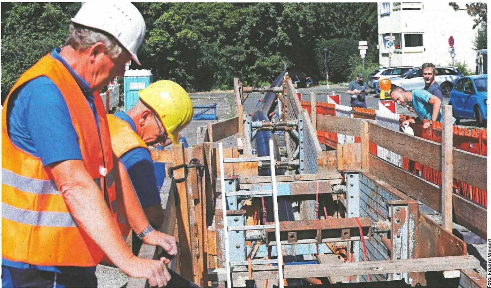
Baugrube in der Apinusstraße: Arbeiter überwachen, wie die neue Leitung [schwarz] hier Zentimeter für Zentimeter in die Bestandsleitung eingeführt wird.
