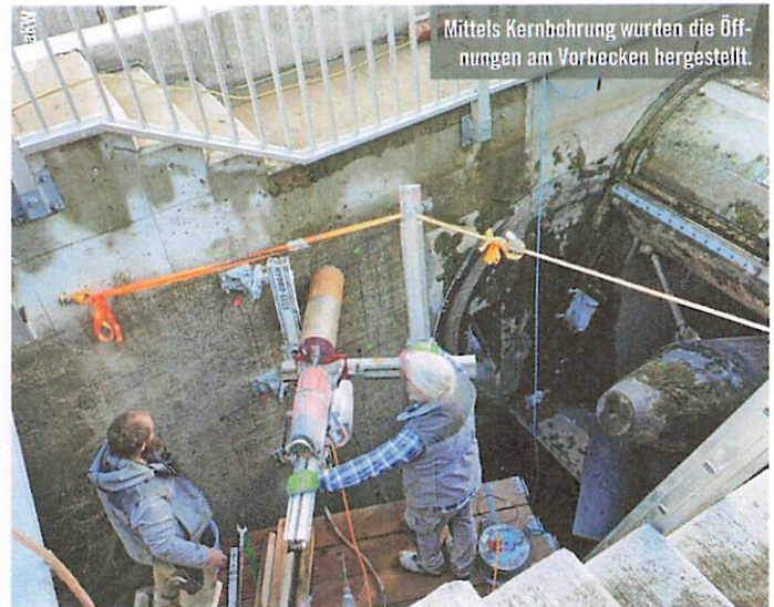
In den Vorbecken sind jeweils vier Öffnungen angebracht, wobei zwei davon stets geöffnet sind. Tests im laufenden Betrieb sollen zeigen, welche von den Fischen am besten angenommen werden.
