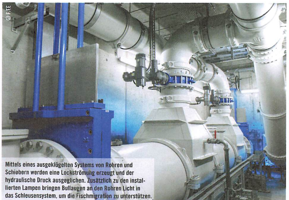
Die Schieber sorgen dafür, dass in der Schleuse für die Fische ungefährliche Druckverhältnisse herrschen.
